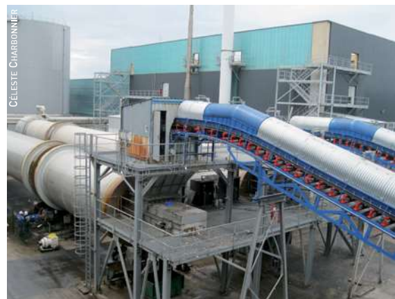
Aperçu de l'unité de méthanisation d'EveRé
