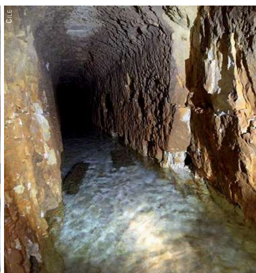
Galerie de captage d'Hesbaye
