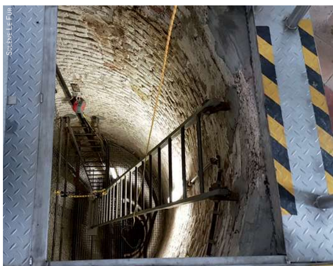
Puit de 3,5 m de diamètre de la station de captage la plus haute d'Hesbaye
